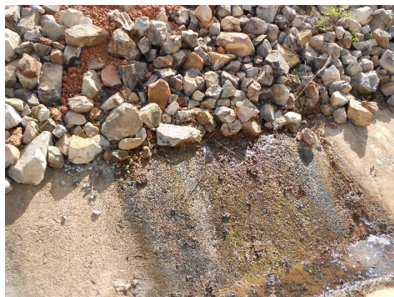
Figura 3 – Surgência na ombreira da barragem Jaburu I
