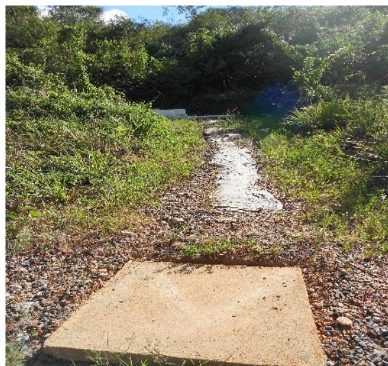
Figura 4 – Surgência no pé da barragem Jaburu I
