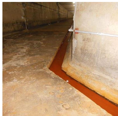
Figura 9– Trecho da galeria da barragem Jaguari com infiltrações
