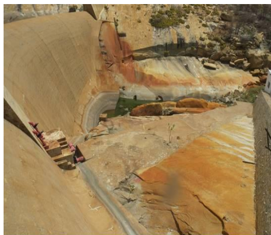
Figura 11– Fissuras no vertedouro
