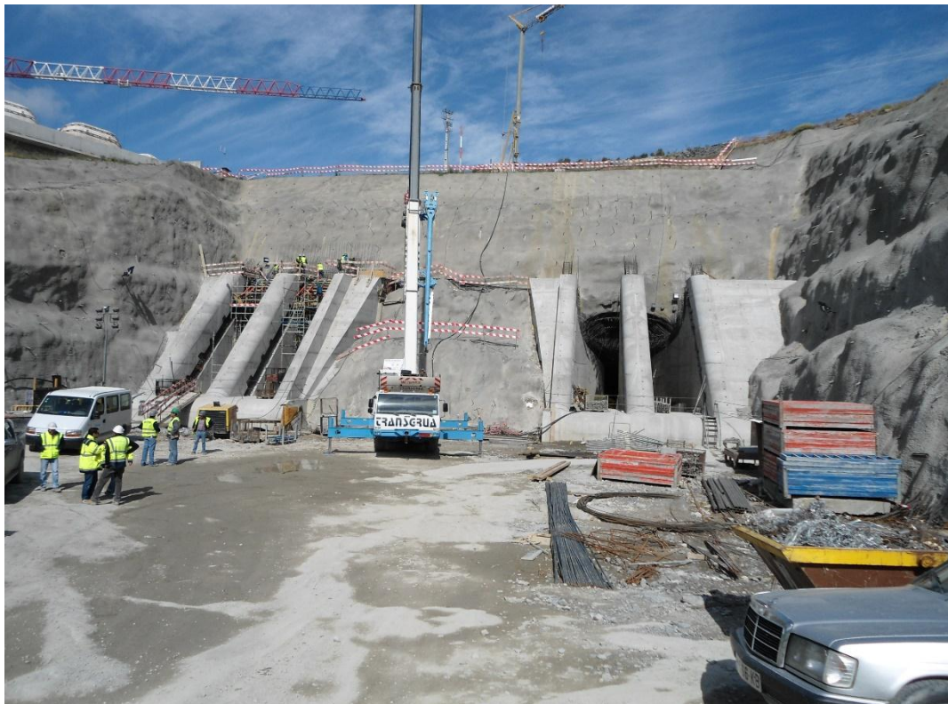
Figura 36. Tomadas de água numa das vertentes seguida de túnel. Barragem do Baixo Sabor, Portugal. (Fonte: Coba, S.A.)
