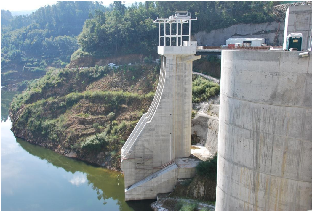
Figura 35. Tomada de água em torre, adjacente à barragem de concreto. Barragem de Ribeiradio, Portugal. (Fonte: Coba, S.A.)
