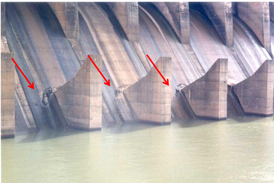
Figura 39. Exemplo de cavitação no concreto por tipo jato cavitante. (Fonte: SBB, Engenharia)
