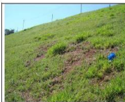
Foto 1.3 - Talude de jusante em boas condições de limpeza, mas com falhas no gramado.
