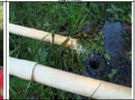
Foto 1.6 - Detalhe de tubulação que sai do poço, que deverá ser cortada, para que se possa medir as vazões.
