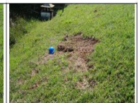
Foto 1.4 - Outro local de falha no gramado de proteção superficial.
